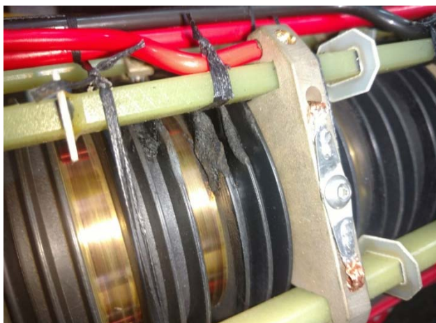
Isoladores derretidos (Figura 3)
