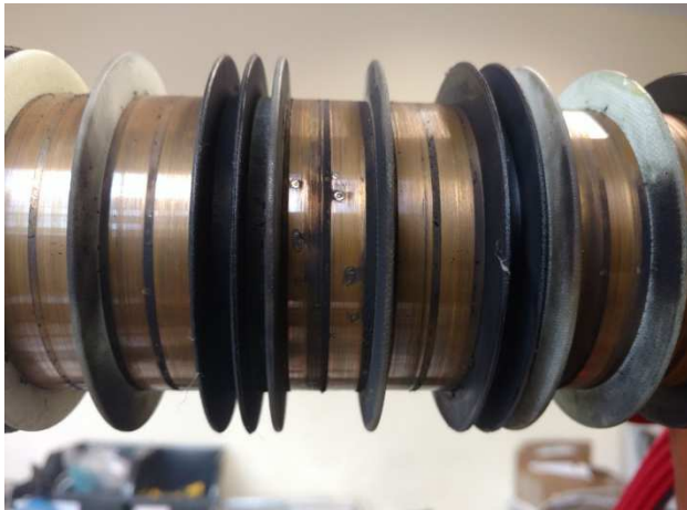
Desmontagem das escovas, sinais de centelhamento em anéis de potência
