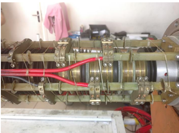
Vias de potência impregnadas (Figura 5)
