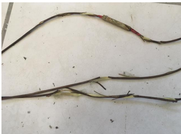
Rabichos de fibra danificados (Figura 3)
