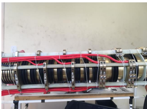
Fios posicionados com amarração
